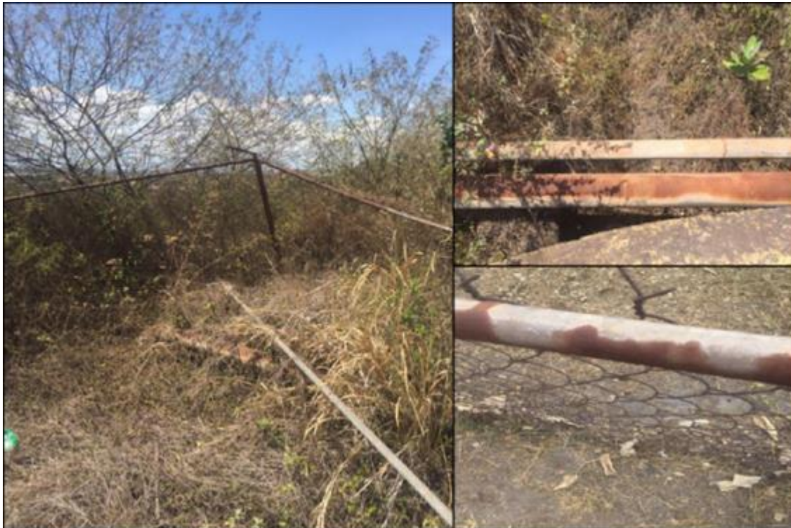
Figura 14. Situación actual de degradación y corrosión de las cercas de acero galvanizado en las inmediaciones al galpón del Taller Automotriz.
