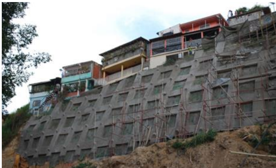
Figura 11. Pantalla reticulada de 16 m de altura, reforzada con geomallas metálicas y geomantas verdes para control de erosión y estabilización de talud (2011). Ubicación: Barrio Santa Cruz, Municipio Baruta,
