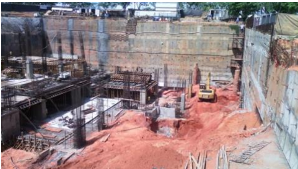
Figura 12. Construcción de muro anclado de concreto armado para sótano del Hotel Meliá en Ciudad Guayana, edo. Bolívar. Tomado de Propuesta de manual para el análisis y diseño de muros anclados de concreto armado y su aplicación en excavaciones profundas en Ciudad Guayana, (p. 68), por Robles y Díaz, 2016, Venezuela. Derechos reservados por Albert Robles y Héctor Díaz.
